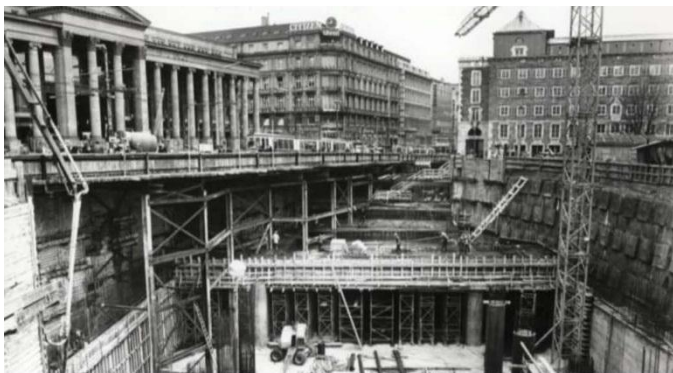
In Stuttgart kann der Tiefbau auf eine lange, erfolgreiche Geschichte zurück blicken.
